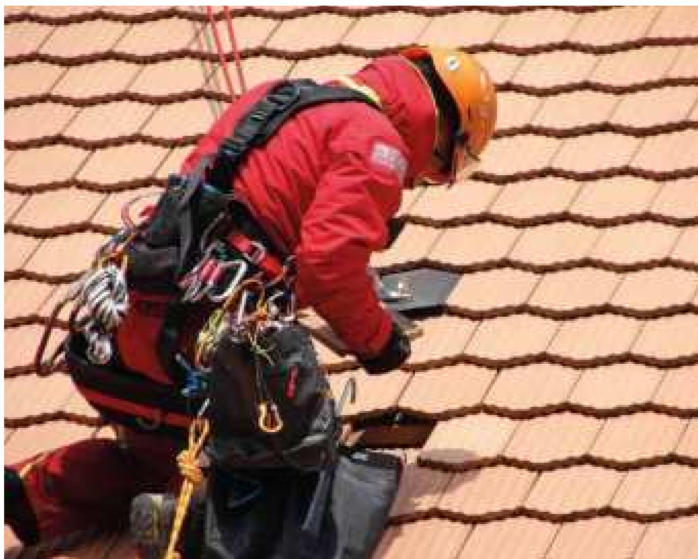
Work on the roof of the parliament of the canton of Vaud. Trabajos en el tejado del Parlamento del cantón de Vaud. Lausanne, Switzerland (courtesy of Corde-Access SA, rigger Andrea Giazzi, ph. Corde-Access SA).
