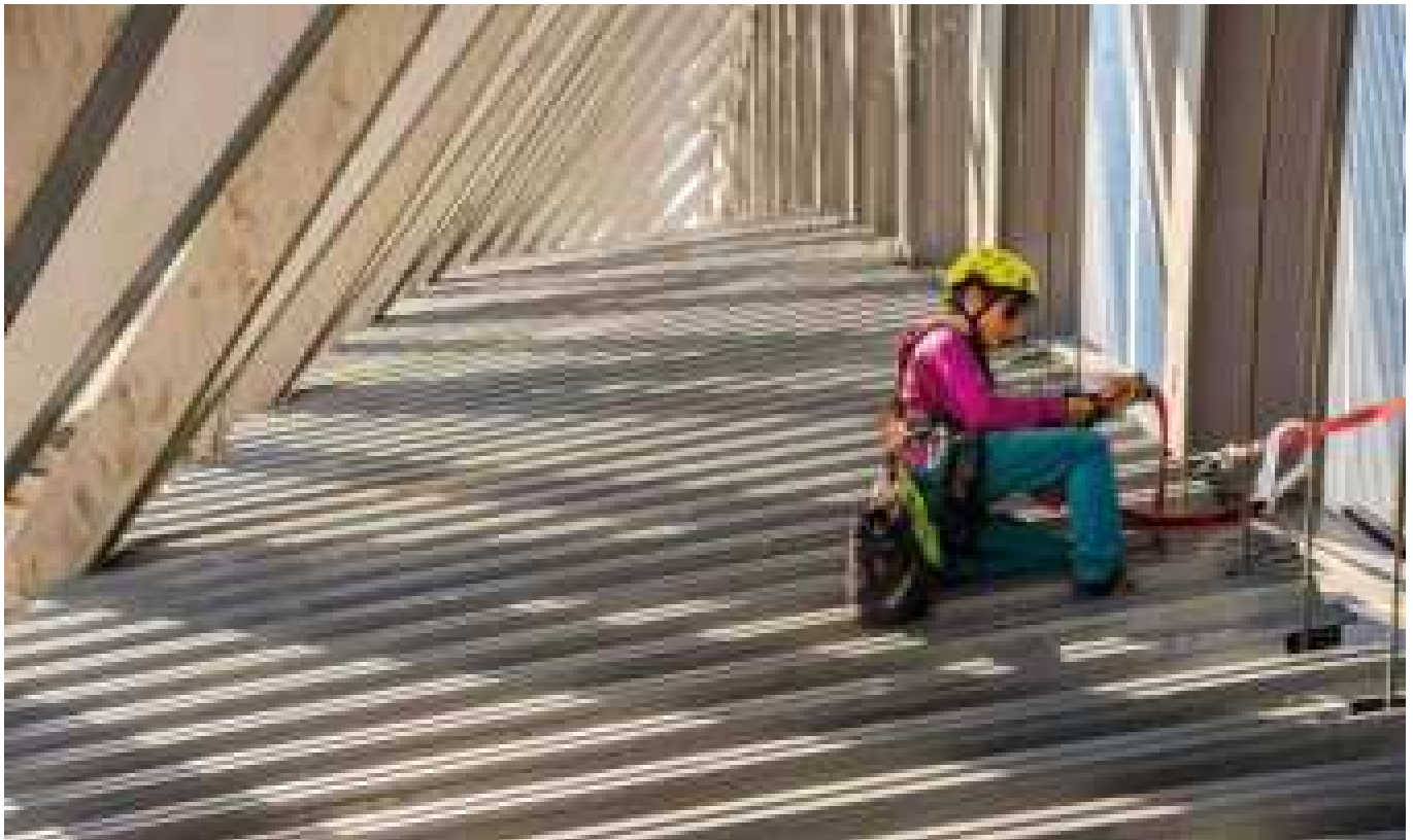
Philippa Betts during inspection operations at the famous Holmenkollen ski-jump structure. Philippa Betts durante las tareas de inspección de la famosa estructura para el salto de esquí de Holmenkollen. Oslo, Norway (courtesy of Varri AS, ph.Kyrre Buxrud).
